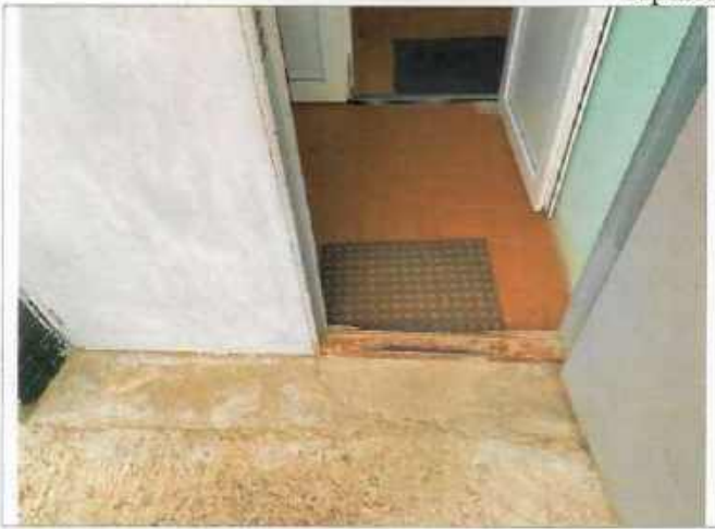
Фото № 7 – Внешняя входная дверь.
